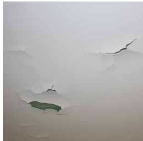
Sichtbare Abblätterung einer Deckenbeschichtung
